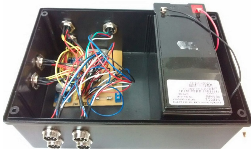
Figura 26 – Vista superior da caixa da miniestação com a placa soldada e posicionada dentro da caixa.
