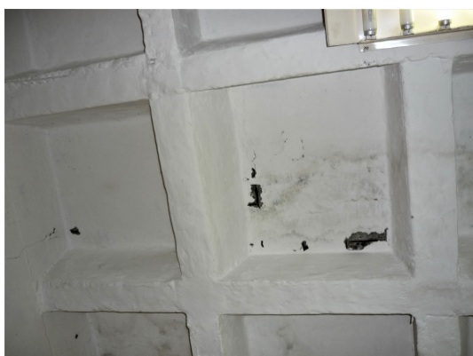
(e) Desprendimiento de hormigón.
