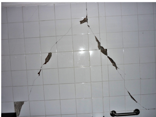
(c) Fisura en baldosa de pared.
