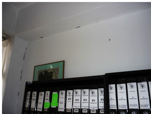
(b) Separación de mampostería.
