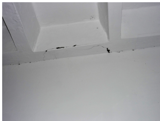
(d) Fisura en nervio de losa.
